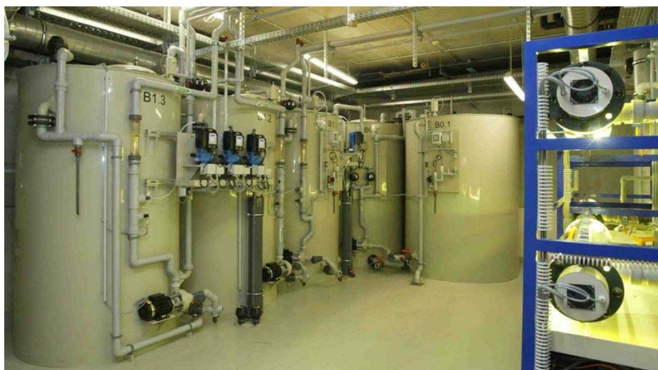
Figura 6. Sistema de tratamiento Foto-Fenton UV para el tratamiento terciario de un efluente industrial (Fuente: Enviolet GmbH, Karlsruhe).
