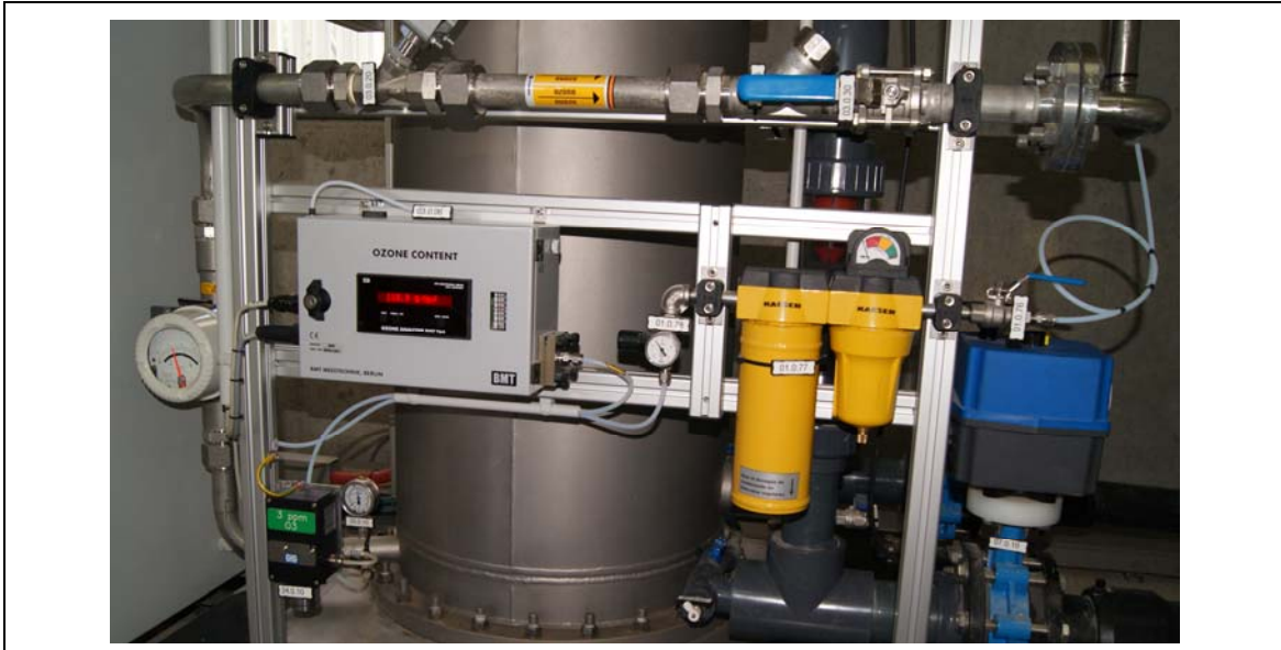
Figura 3.- Detalle del medidor de ozono en la producción de gas. ETAP-Lugo.
