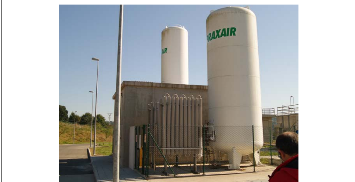
Figura 1.- Sistema de refrigeración y almacenamiento de oxígeno (ETAP-Lugo).
