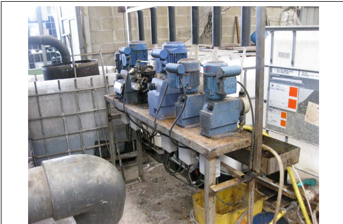
Figura 3. Sistema de adición de reactivos para regulación de pH en un tratamiento físico-químico (Arteixo. España)
