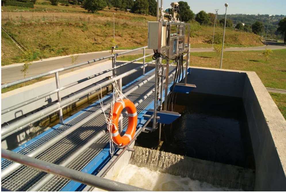
Figura 2. Canal de regulación de pH en cabecera (ETAP-Lugo)
