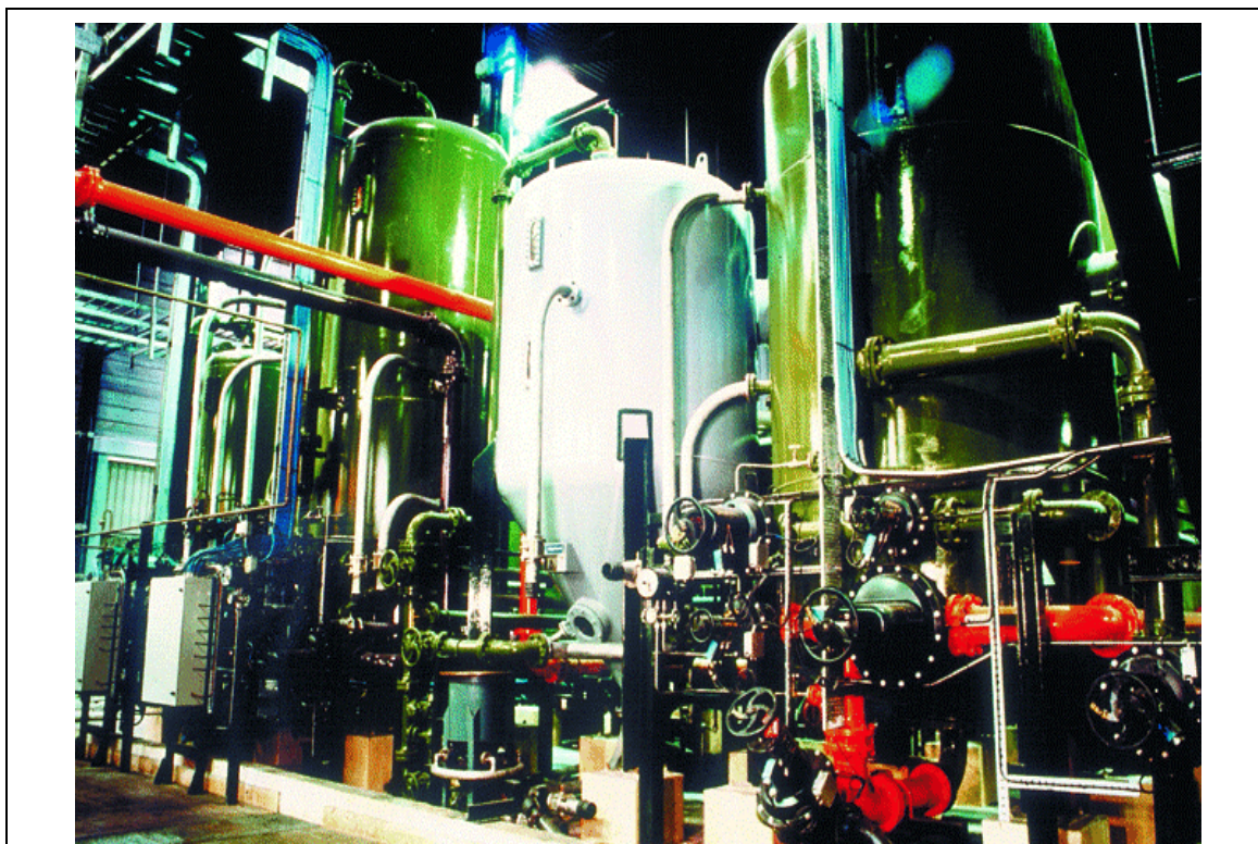
Figura 3.- Sistema de intercambio iónico para desmineralización de agua de calderas. Dos líneas sistema Up Flow Dégremont. Caudal: 2 \times 48 \text{ m}^3/\text{h} . (Dégremont, 2001)
