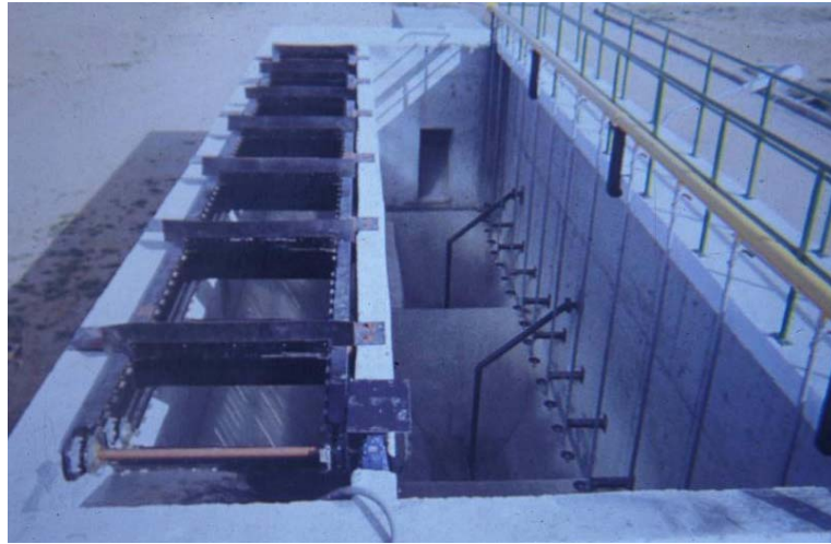
Figura 7 Canal desarenador-desengrasador aireado sin puente móvil.
