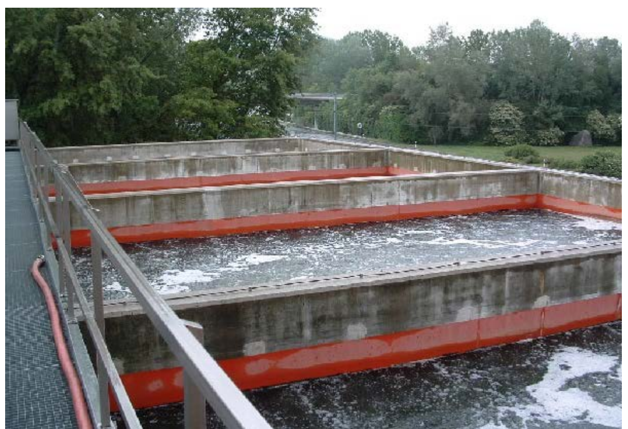
Figura 1.- Sistema de biofiltros de la tecnología Biostyr
